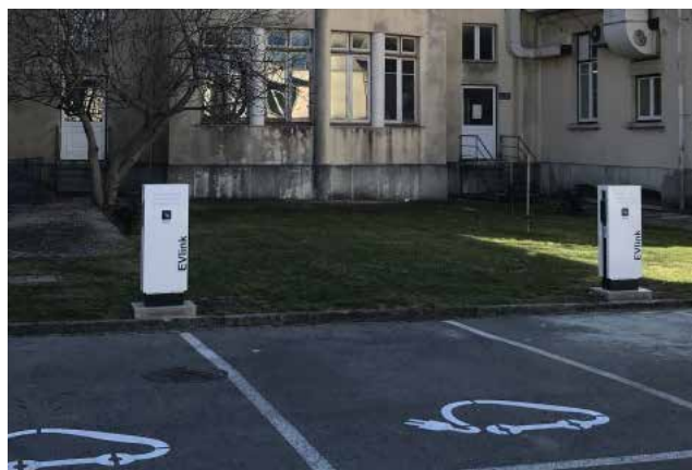
Postos de carregamento para veículos elétricos no Campus de Benfica
